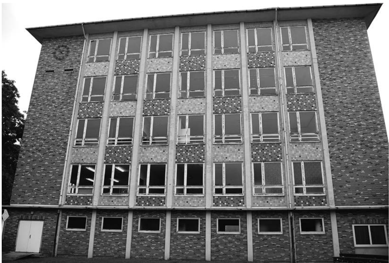
In die Jahre gekommen: Die Gebäudefront des Turms der Fritz-Reuter-Schule
