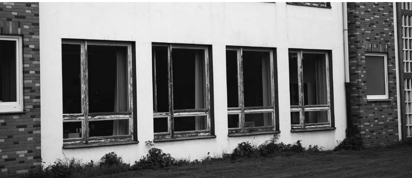
Ebenfalls ein Sanierungsfall: Eine alte Fensterfront der Werkstattschule, Hinrich-Schmalfeldt-Str. 26, Bremerhaven
