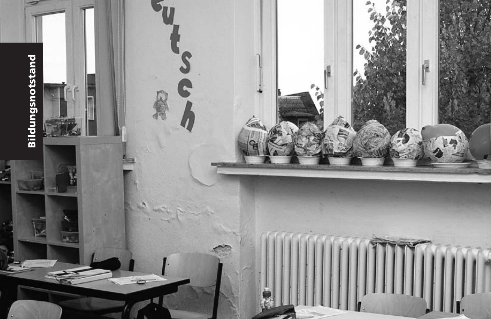
Der Putz bröckelt: Ein Klassenraum in der Allmerschule, Allmersstraße 2, Bremerhaven-Geestemünde
