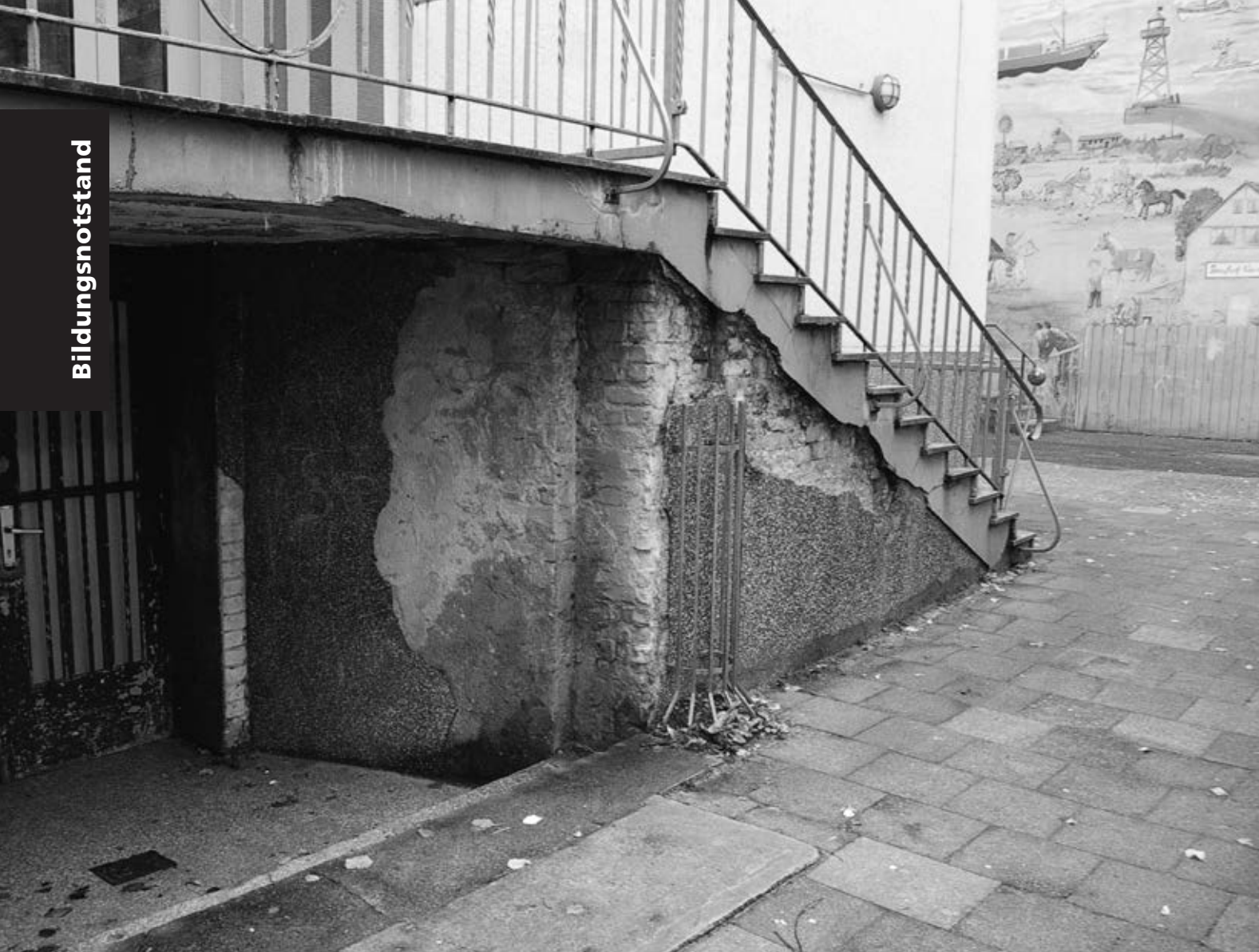
Dringender Sanierungsfall: Der Eingang zur Fritz-Reuter-Schule, Braunstraße 5, Bremerhaven-Grünhöfe
