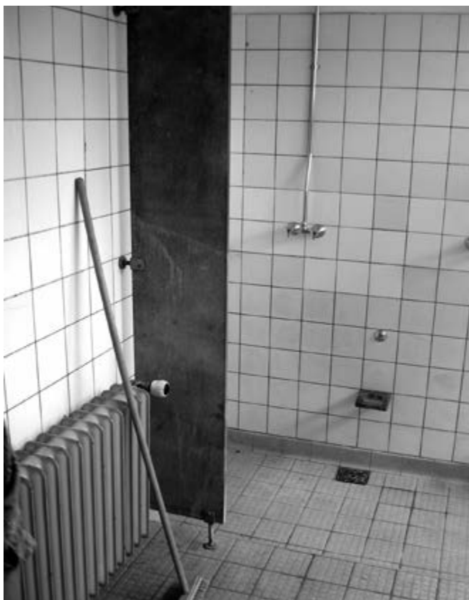
Duschraum der Turnhalle – ein Sanierungsfall
