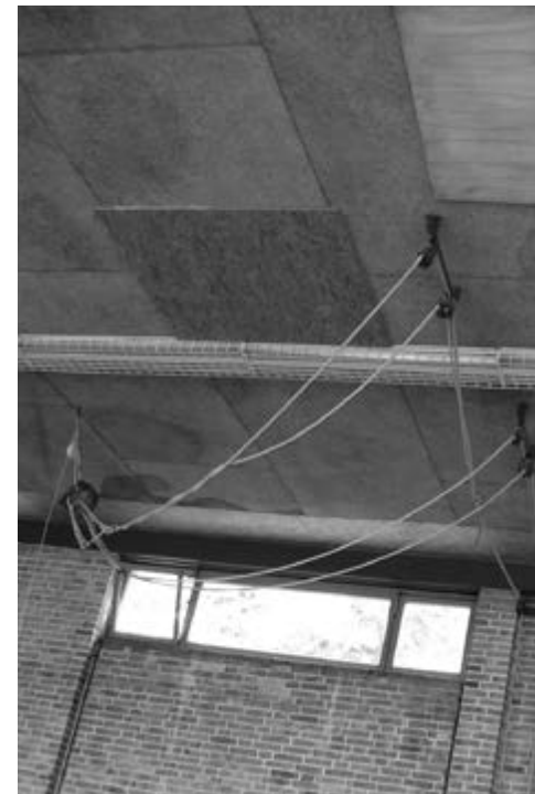
Grundschule Oslebshauer Heerstraße: Notdürftige Deckensanierung, Nässe auf dem Hallenboden
