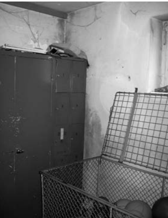
Schimmel im Geräteraum
